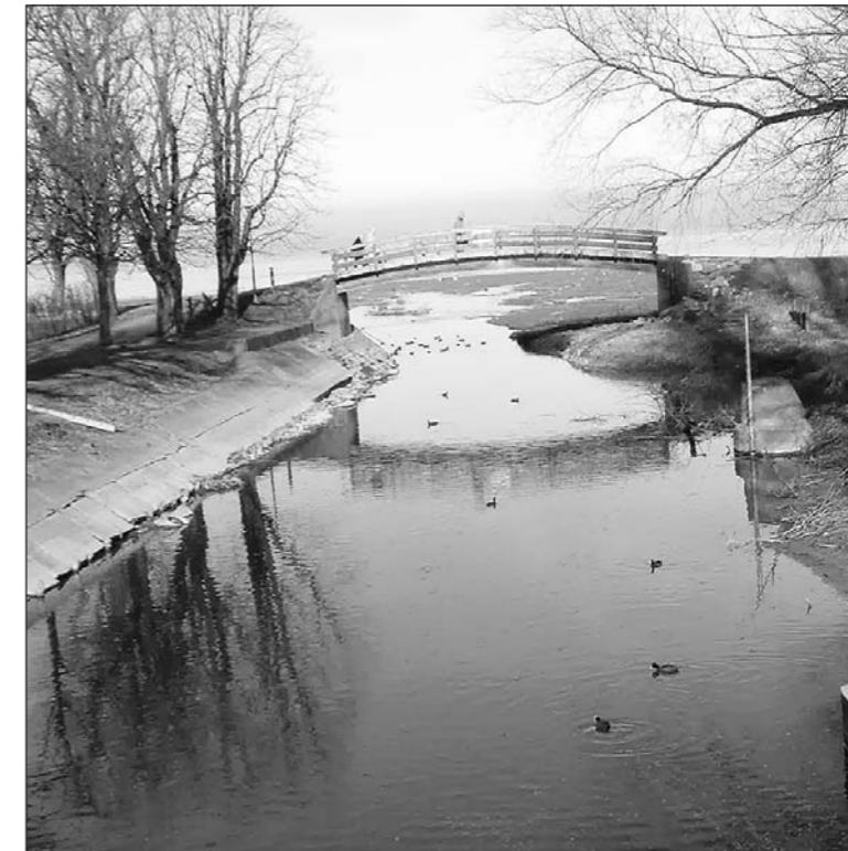
Demnächst beginnen die Sanierungsarbeiten des Abwasserverbandes Morgental an der Seeleitung im Steinacher Naturschutzgebiet.
