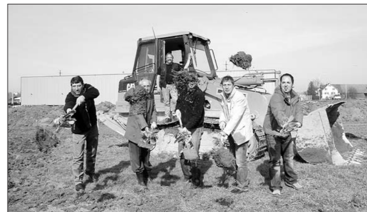
Bauherr Peter Federer (hinten auf dem Trax) freut sich über den schwungvollen Spatenstich für die Erschliessung der Blumenaustrasse.
