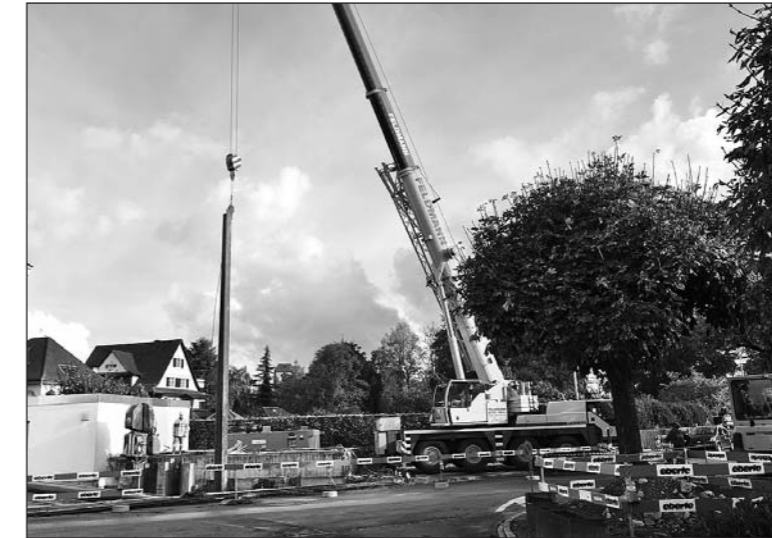
Ende Juni 2010 soll die neue Anlage «Hochwasserpumpwerk Quai» am Adolf-Saurer-Quai in Betrieb genommen werden.
