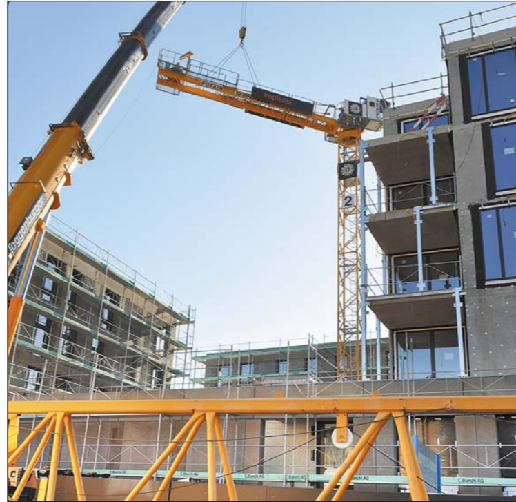
Die Überbauung Rosengarten nimmt immer konkretere Formen an. Am Mittwoch, 15. Juni, kann sich die Bevölkerung ein Bild vom Baufortschritt machen. Kürzlich wurde auch der zweite von drei Baukrans abgebaut.
