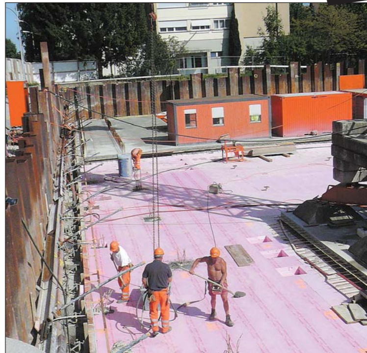
Während im westlichen Teil der zukünftigen Sporthalle die letzten Kubikmeter Aushubmaterial abtransportiert werden, hat das Team um Polier Rolf Bommer, mit einem ausserordentlichen Sondereinsatz bis in die Nacht, die erste Etappe der Bodenplatte betonierte. Diese ist im Hintergrund erkennbar und dient nun als Materialdepot für den Hochbau. Im Bildvordergrund die flächendeckenden rosaroten Dämmelemente, auf deren Grundlage der Beton für die Bodenplatte eingebracht wird. Erfreulicherweise sind momentan alle Arbeiten sowohl monetär als auch terminlich auf Kurs.
