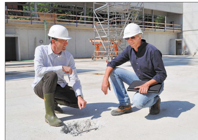
Sekundarschulpräsident Hanspeter Keller (links) und Bauingenieur Ralf Schoster von Näf & Partner rätseln, weshalb sich die Bodenplatte der Sporthalle im Stacherholz um nicht weniger als 23 Zentimeter gewölbt hat.
