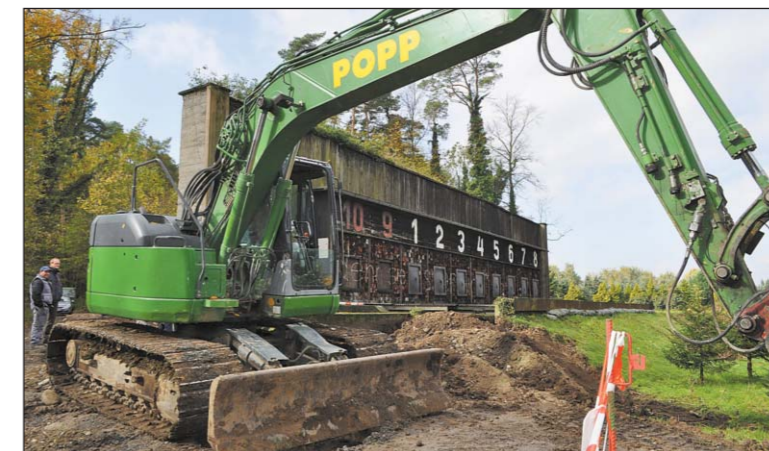
Die Verteilung der Bleibelastung lässt vermuten, dass das alte Kugelfangmaterial beim Bau des Stirnholzkugelfangs (ca. 1948) in dessen Umgebung verstossen wurde. Diese Fläche muss nun saniert werden.
