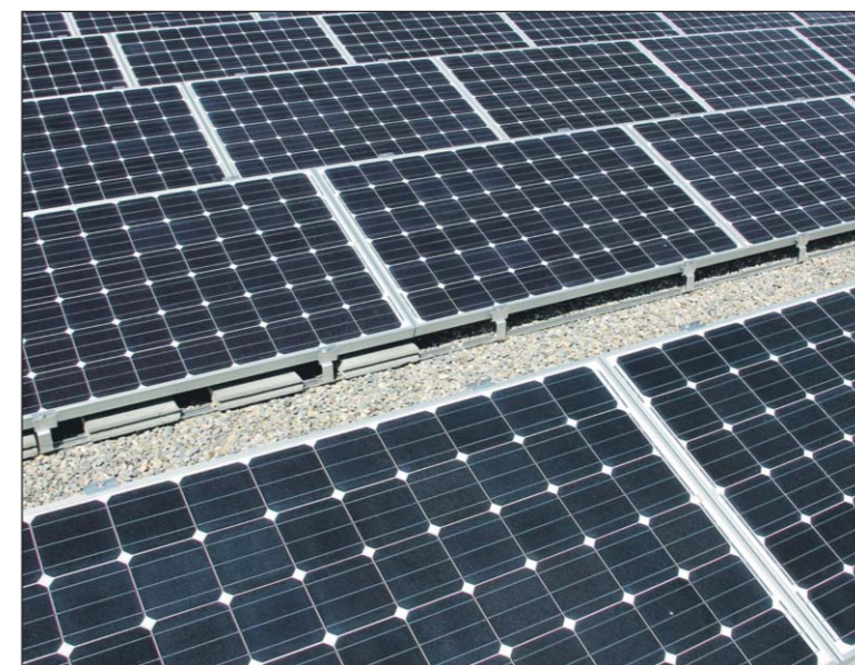
Es gibt in Arbon immer mehr Fotovoltaikanlagen, die Nachfrage hält mit dem Angebot aber nicht mit.
