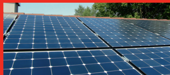
Einfamilienhaus Wittenbach | Aufdachanlage | Leistung: 8,82 kWp
