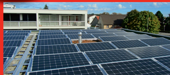
Raiffeisenbank Wittenbach | auf Flachdach | Leistung: 33,075 kWp
