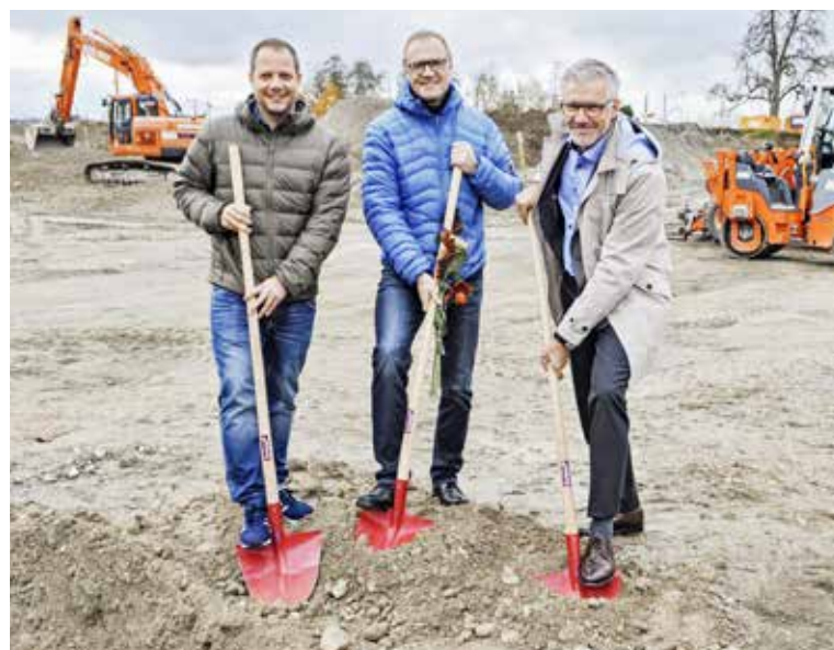
«Auf einen erfolgreichen Bauverlauf»: Gesamtprojektleiter Roger Rutz, Horns Gemeindepräsident Thomas Fehr und Fortimo-CEO Elias Zürcher (v. l.).
