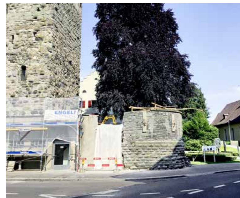
Die beschädigte Sandsteinkanzel an der Hauptstrasse muss abgebrochen werden.
