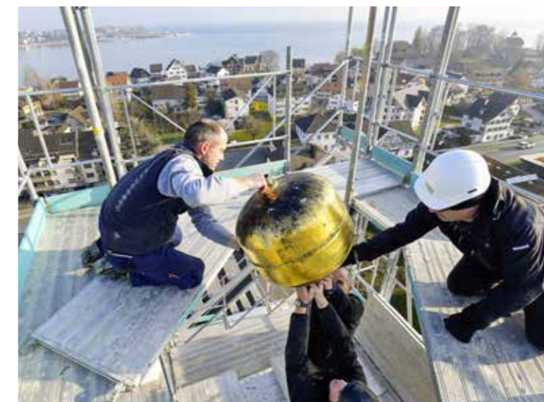
Die goldene Kugel wird von der Steinacher Kirchturmspitze demontiert. Das vom berühmten Architekten Jakob Grubenmann geplante Gotteshaus erfährt eine Aussenrenovation.
