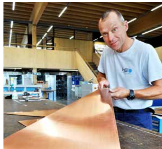
Spengler Otto Jutz bearbeitet ein Rollenblech für das frisch renovierte Dach des Awit-Geschäftssitzes in Arbon.
