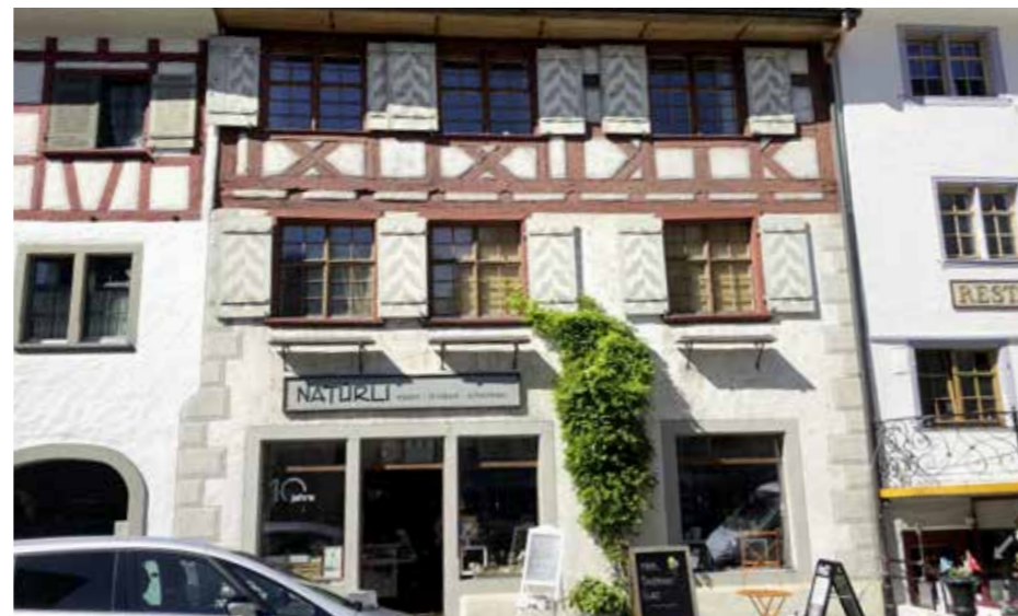
Das Team des «Natürli» und die Mitarbeiter des Malergeschäfts «Letti - Ihr Maler» präsentieren stolz die frisch gestrichene Fassade (Bild oben). Der Unterschied zu vorher (Bild unten) ist unübersehbar: Das Gebäude erstrahlt jetzt wieder in neuem Glanz.
