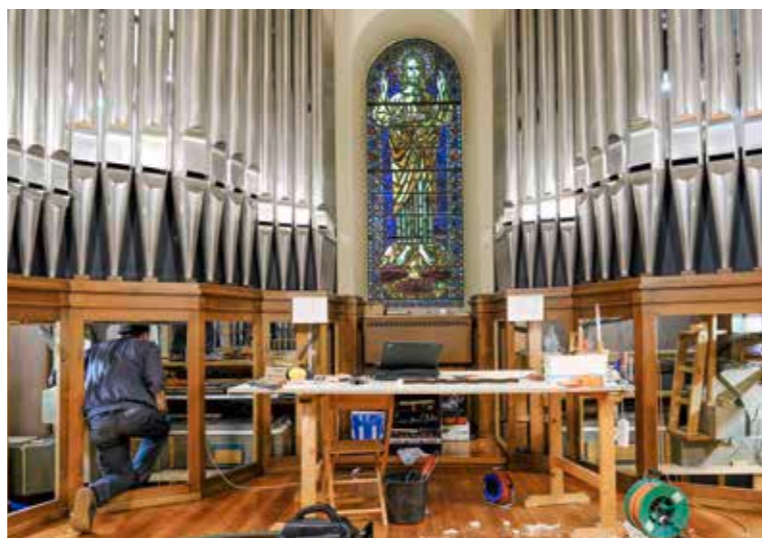
Hinter den sichtbaren Orgelpfeifen befindet sich ein kleines Labyrinth von Leitern, schmalen Durchgängen, Rohren und elektrischen Verbindungen.
