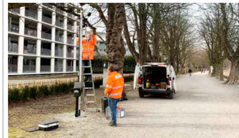
Fachleute montieren an der Arboner Kastanienallee das Zählgerät.
