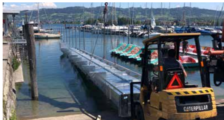
Der neue, im Rheintal produzierte, Metallsteg wird beim Schlipf, neben dem Hafenkiosk, per Kran ins Wasser gehievt. (Bild: Jürg Rötheli)
