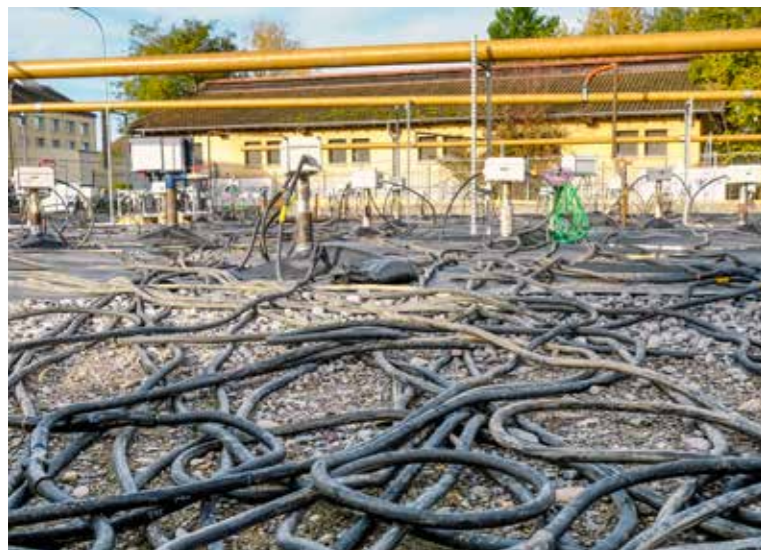
Unzählige Kabel führen zu den einzelnen Elektrosonden, die jeweils mehrere hundert Grad warm werden. Die Erde zwischen den einzelnen Sonden wird damit so weit erhitzt, dass die Altlasten im Boden verdampfen.
