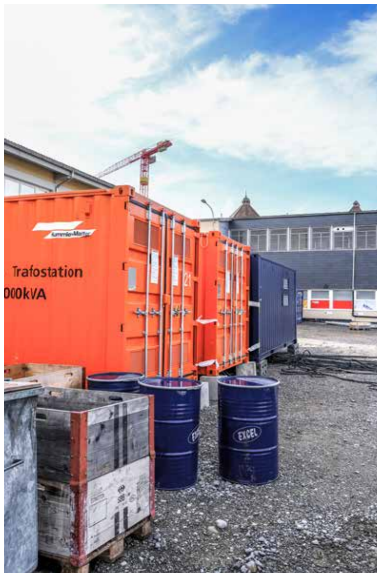
Zwei der fünf orangen Trafostationen, die zur Zeit zur Stromversorgung auf dem Raduner-Areal aufgestellt sind. Im blauen Container daneben wird der Strom in die für die Erderhitzung notwendige Form gebracht.
