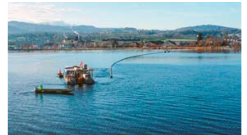
Die Seeleitung, hier während der Bauphase im Sommer, liefert Energie für knapp 1000 Haushalte und trägt zur Einsparung von circa 800 000 Liter Heizöl bei. z.V.g.
