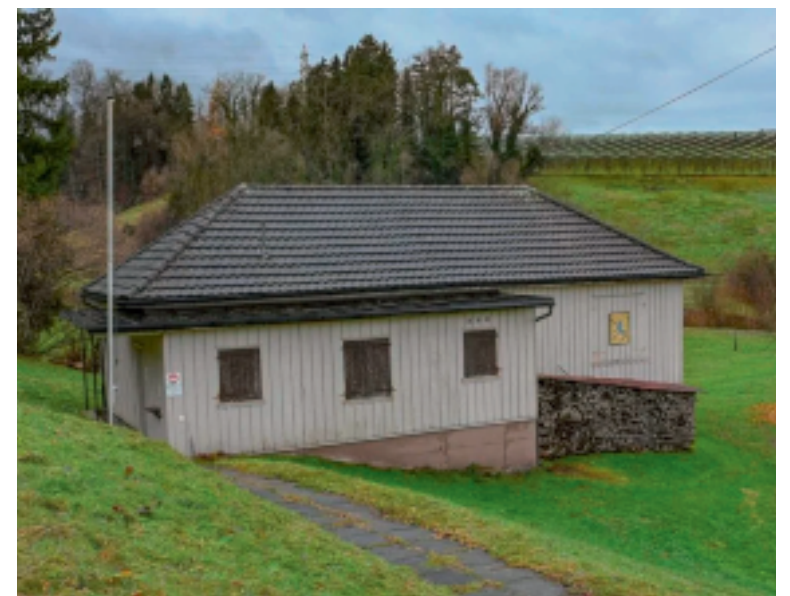
Die Sanierung der ehemaligen Schiessanlage Buholz wird wegen PFAS-Belastungen deutlich teurer als ursprünglich geplant. z.V.g.
